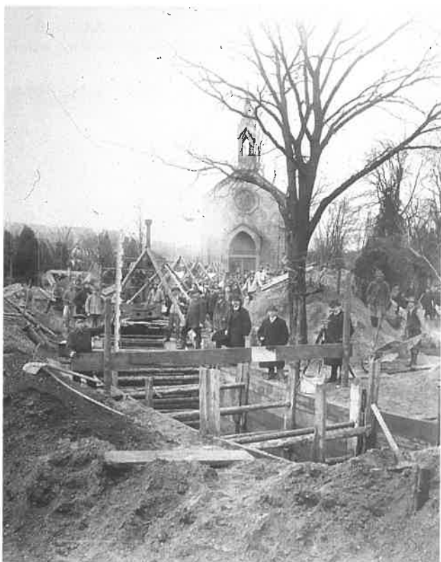
Bauarbeiten am Landgraben für die Karlsruher Kanalisation. Baustelle am Alten Friedhof in der Oststadt.
